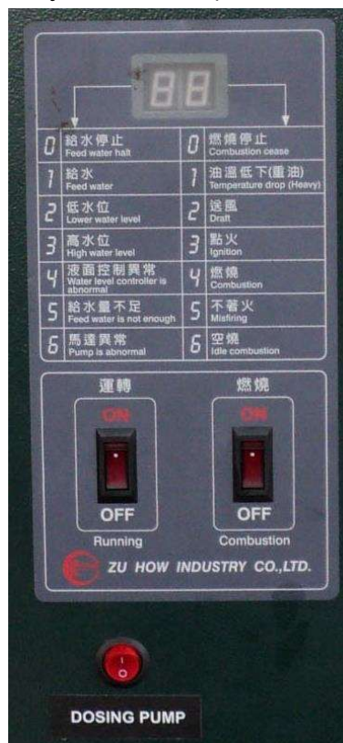
รูปที่ 9: ภาพขยายแผงควบคุมหม้อน้ำ
