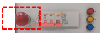
ภาพที่ 3-2 สวิตช์ตัดตอนเมื่อเกิดเหตุฉุกเฉิน
